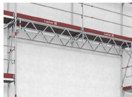
Interruzione del ponteggio.
